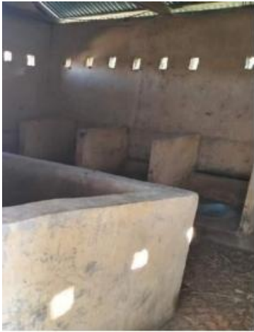
Bangunan Pemandian Umum MCK Sebelum di renovasi
